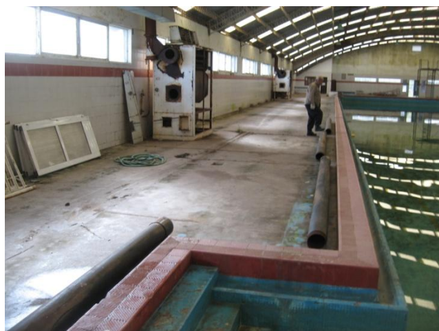
Figura 6. Detalle de los equipos de calefacción en desuso
