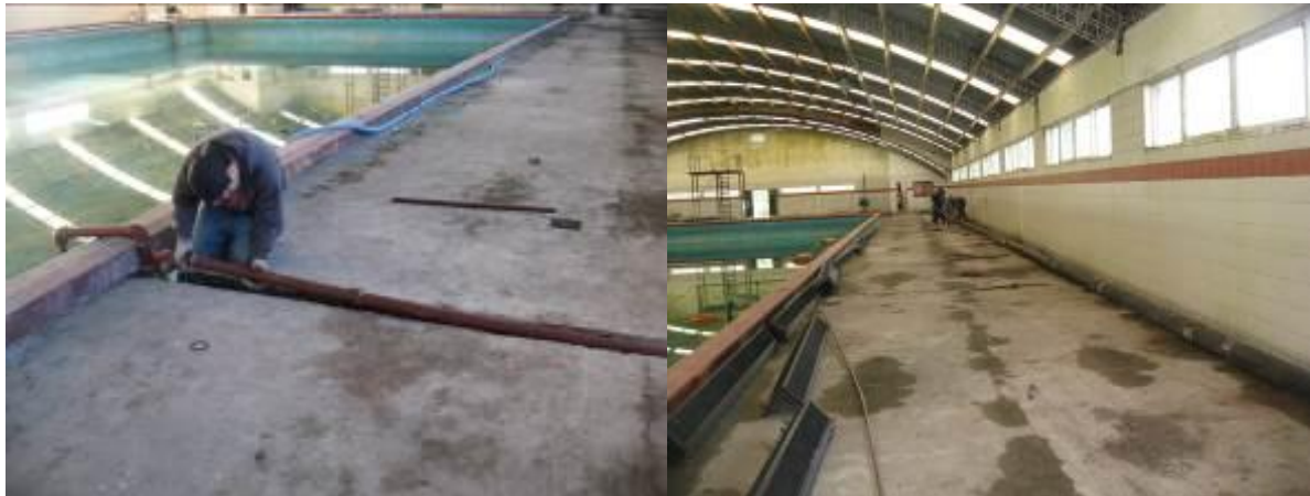
Figura 4. Instalación en el natatorio
