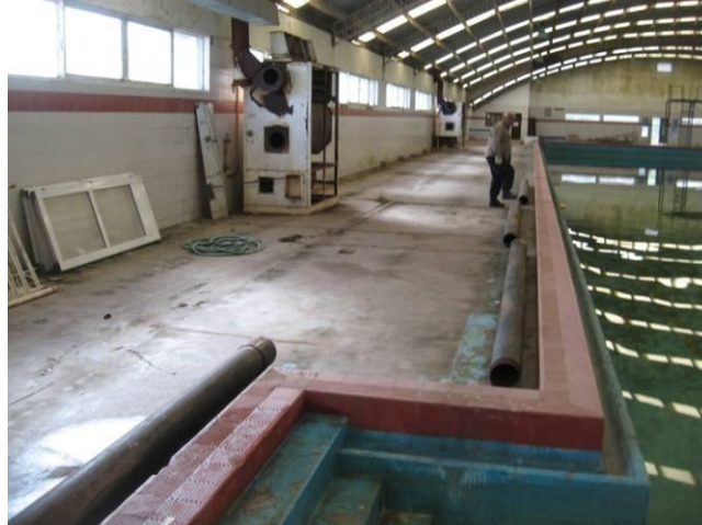
Figura 8. Equipos de calefacción originales
