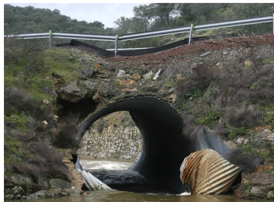
Figura 1.- Ejemplo de corte del servicio en infraestructura fruto del fallo de una obra de drenaje transversal: colapso estructural.
