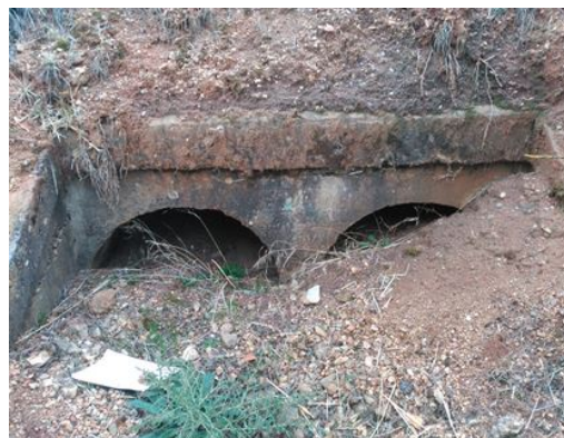
Figura 2.- Ejemplo de patología: obstrucción del conducto.
