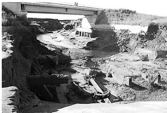
Figura 1.- Daños sobre puente en Ruta Nacional N°8, San Luis.
