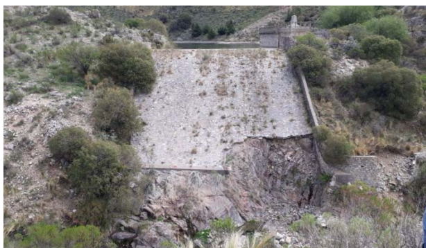
Figura 1.- Vertedero de descarga del Dique Los Alazanes posterior a la rotura por erosión.
