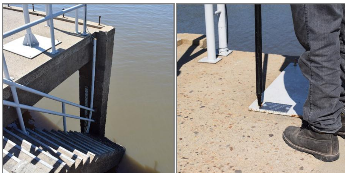
Figura 2.7. Escala hidrométrica 1 (izquierda) y placa instalada (derecha)
