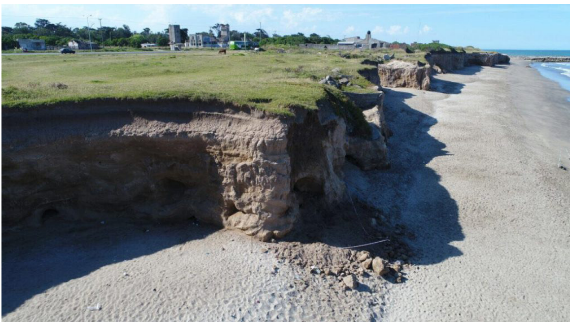
Figura 4.8. Derrumbe de acantilado en Balneario Las Delicias (Camet) (Fuente: La Capital Mar del Plata ).
